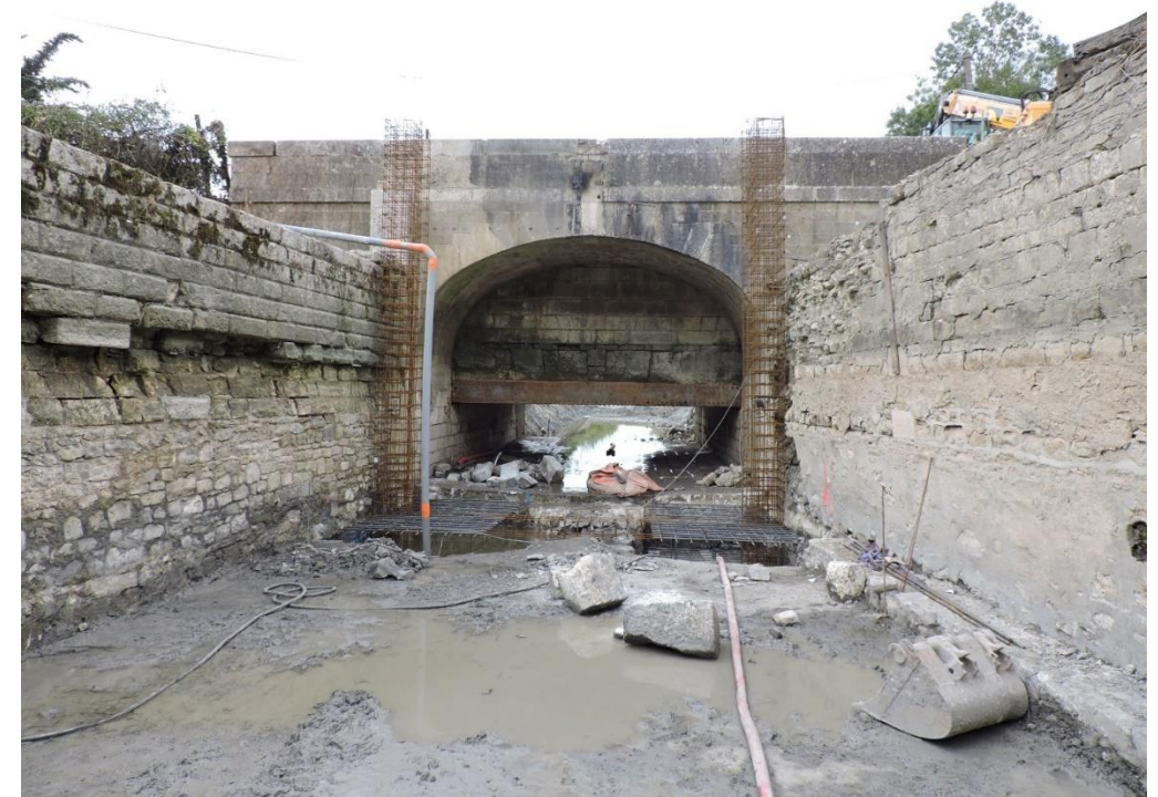
Siphon asséché au Gouffre de l'Île d'Elle
